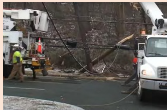
Gráfico 14. Líneas eléctricas caídas como consecuencia de la tormenta de hielo (WUSA9).
